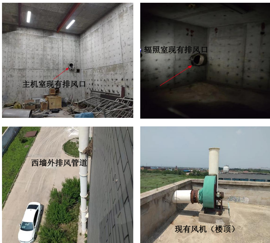
图 10-10 本项目现有排风装置情况
